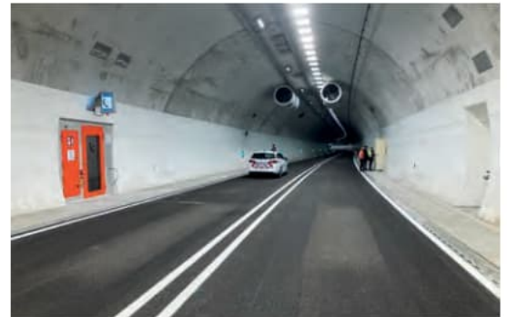
Ein- und Durchfahrtsbeleuchtung
