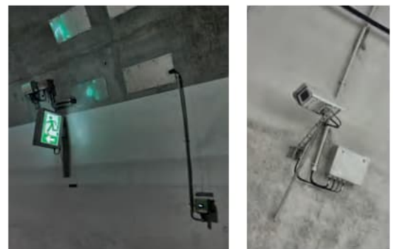
Messanlage und Videoüberwachung
