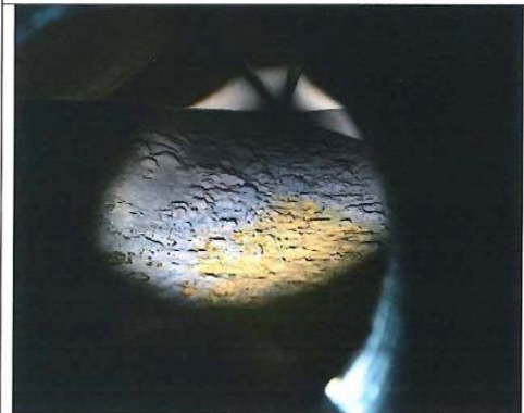
Bild 3 Langkesselsohle mit Korrosionsspuren
