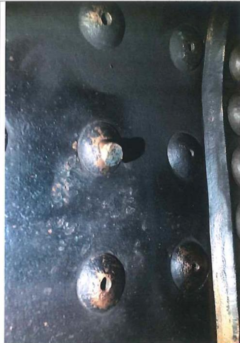
Bild 5 Vernagelter Stehbolzen in der rechten Seitenwand der Feuerbüchse
