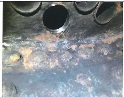
Bild 4 Materialabtrag in der Rauchkammer
