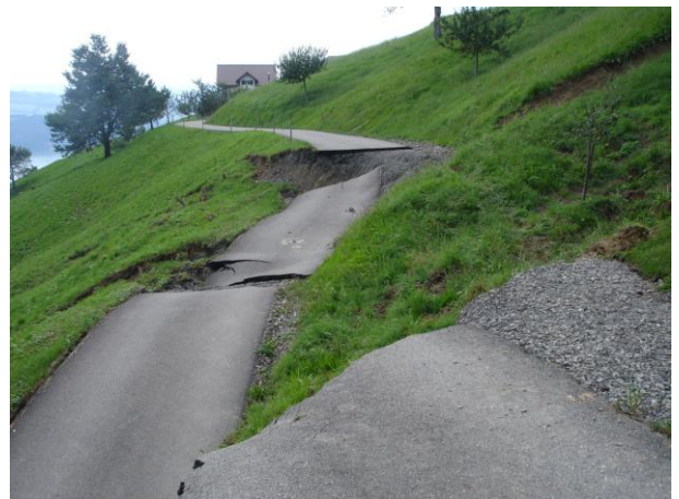
Abb. 1: Zerstörte Strasse nach einer Spontanrutschung am Rufiberg (Arth) im August 2005. Foto: AWN.
