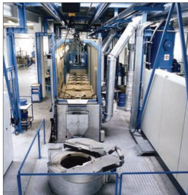
Bild 70: Automatisierte Salzbad-Nitrocarburieranlage (Fa. Durferrit)
