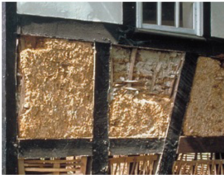
Abb. 4: Beispiel stark beschädigter Gefache, Stakung erkennbar (Quelle 4, S. 290)
