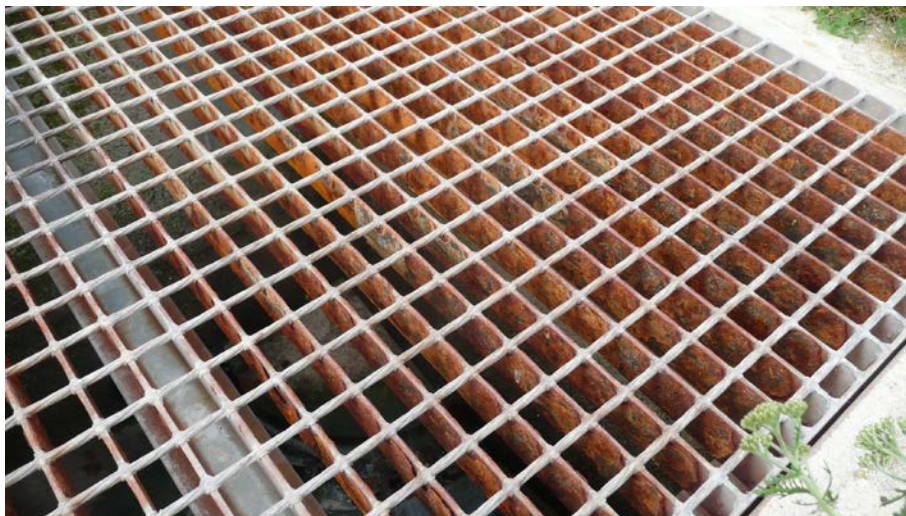
Abbildung 16: Starke Korrosion am Trübwasserschacht des geschlossenen Schlammstapelbehälters der Anlage SG, 28.09.2015
