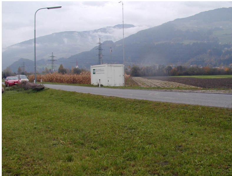
Abbildung 2.5: Messstation "Unterfeld" der NUA
