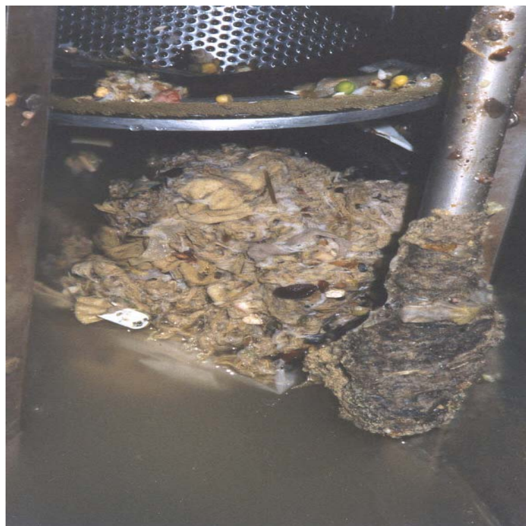
Abbildung 5–32: Zulauf Siebschnecke, Frachtanfall
