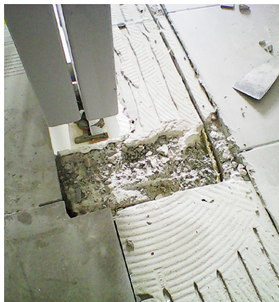
Abb. 9: Beispiele an nicht ordnungsgemäß ausgeführten Trennfugen in einem Stiegenhaus und im Eingangsbereich einer Wohnung, © ABT15
