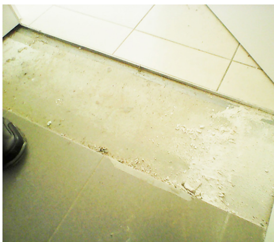
Abb. 10: Beispiele an nicht Ordnungsgemäß Ausgeführten Trennfugen in einem Stiegenhaus und im Eingangsbereich einer Wohnung, © ABT15
