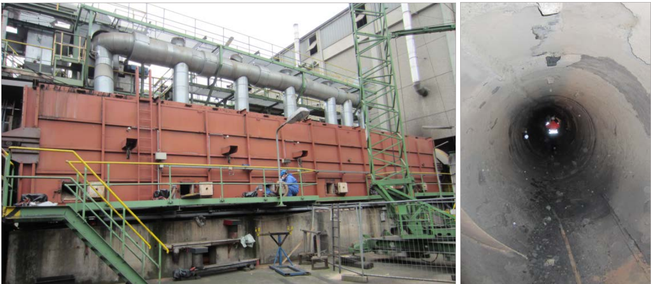
Abbildung 3.22: Pyrolysedrehrohr der MPA Burgau. Links: Außenansicht mit Heizkammer und Heizgasabzugsrohren, rechts: Innenansicht (eigene Aufnahmen).
