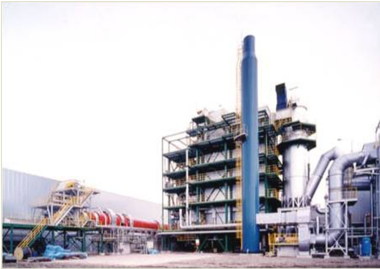
Abbildung 3.12: Foto einer Anlage nach dem Takuma Pyrolysis Gas Meltina System.
