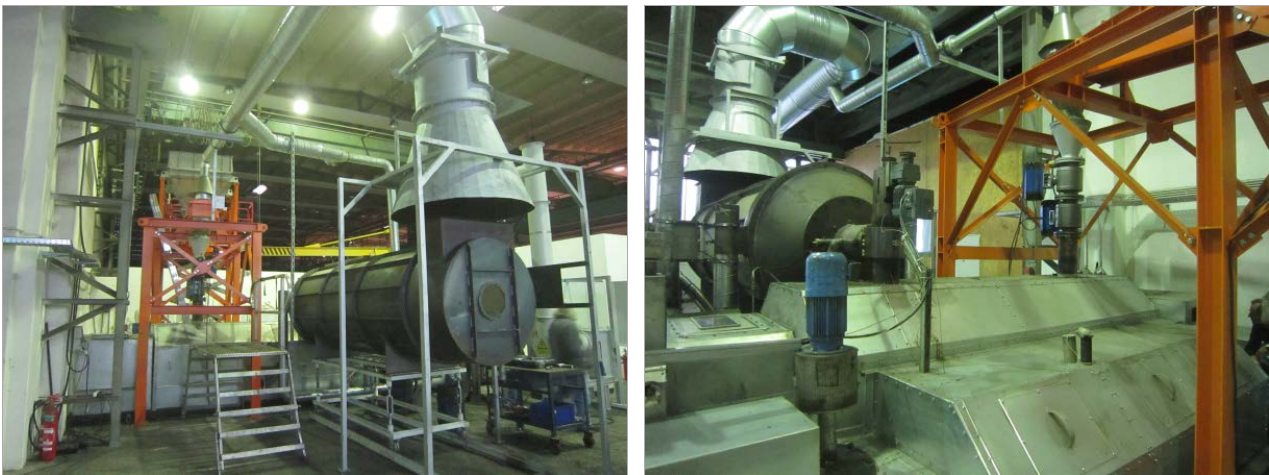
Abbildung 3.27: Links: MEE-Anlage Schwerin, abgebildet im Vordergrund Brennkammer, im Hintergrund Aufgabesystem und querliegender Reaktor; rechts: rückseitige Ansicht Reaktor mit Brennstoffaufgabe (eigene Aufnahmen).
