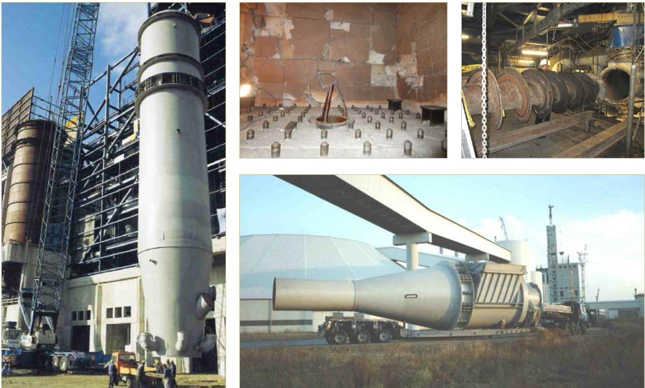
Abbildung 3.68: ZWS-Vergaser (links) und Heißgaszyklon (unten) vor der Montage am Standort Rüdersdorf [Cemex 2013]. Oben Mitte: Innenansicht Aschekühler, oben rechts: Eintragschnecke (eigene Fotos).
