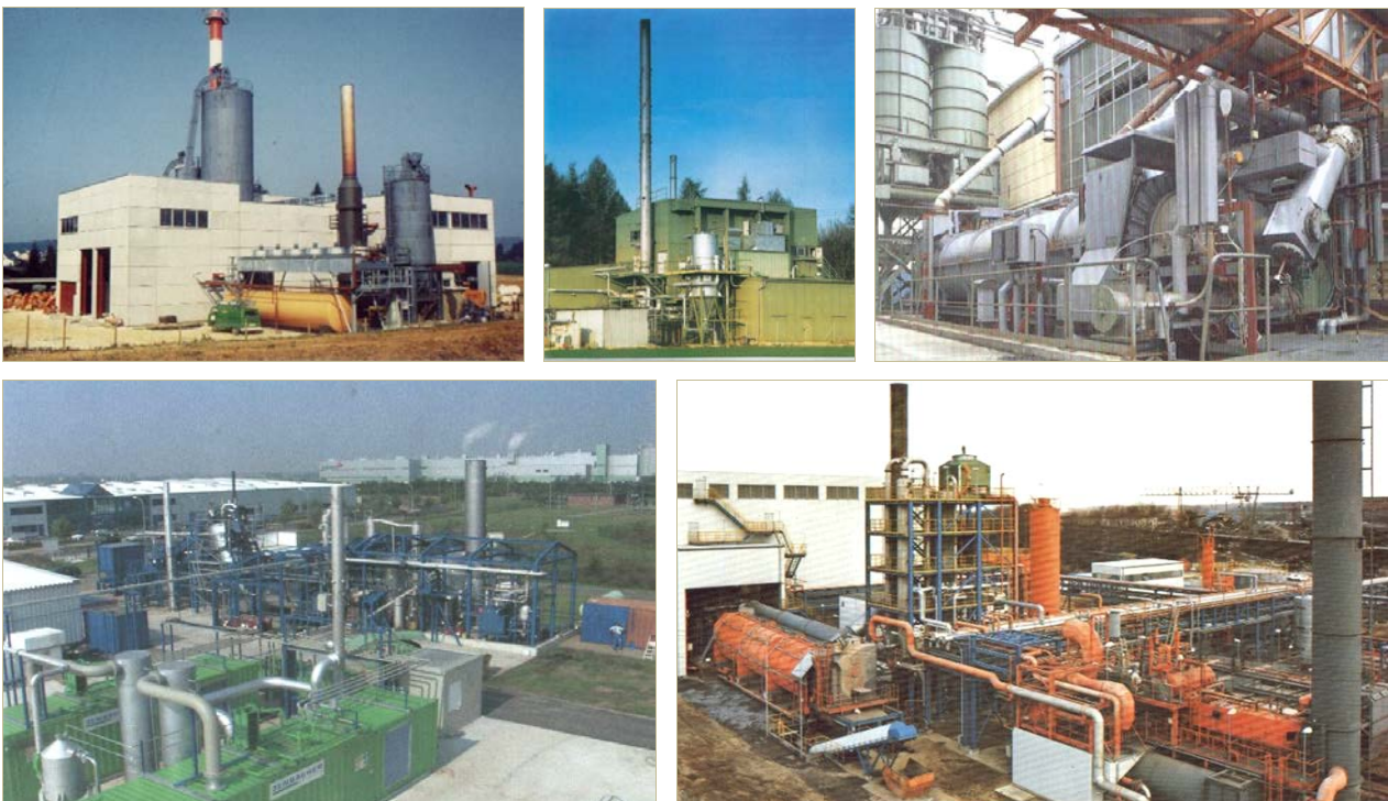
Abbildung 4.3: Großtechnische Pilotanlagen zur Abfallpyrolyse, Anfang der 1980er Jahre in Deutschland: Goldshöfe, Ulm-Wiblingen, Bernau (oben, von links), Eilenburg und Salzgitter (unten von links) [Pruckner 2008].
