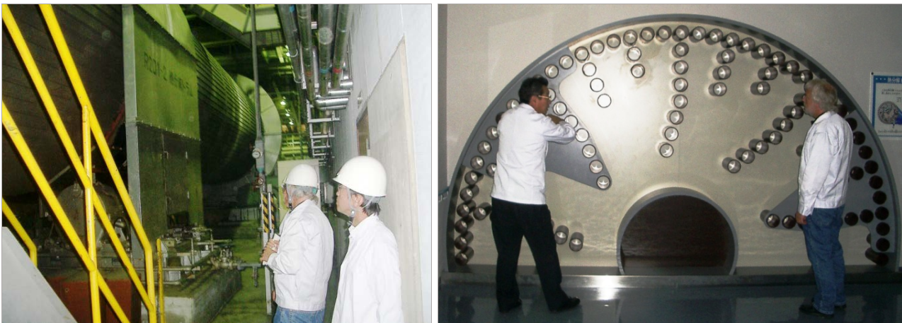
Abbildung 3.7: Pyrolysetrommel von außen (links) und Anordnung der dampfbeheizten Rohre im Inneren der Pyrolysetrommel (rechts) in der MES R21 Anlage Toyohashi [MITSUI 2004].
