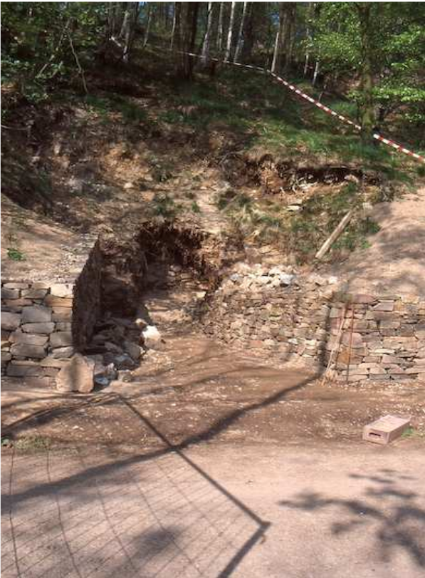
Bild 10: teilweise geöffnete Verwahrungsmauer des Mundlochs. Der Stolln dahinter ist größtenteils bis unter die Firste verfüllt.
