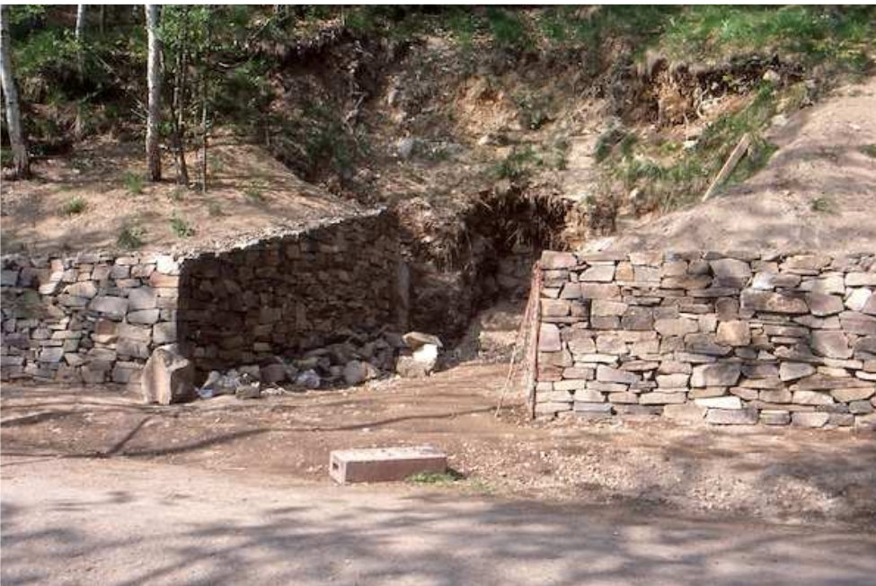
Bild 9: Mundloch des Pegmatitstolln während der Aufwältigung. Das Material für die Trockenmauern stammt fast ausschließlich aus dem Granulitsteinbruch Seifersbach/Mittweida.
