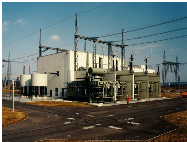
GKK Etzenricht (1993 – 95), in der für die HGK Wolmirstedt geplante/gefertigte Anlagenteile zum Einsatz kamen
