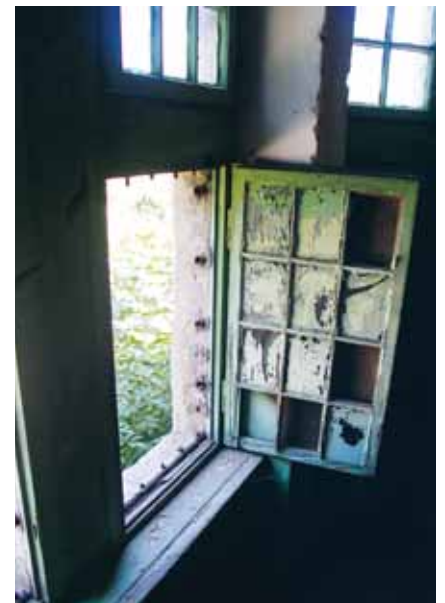
Abb. 12 Fenster 14.7.2006, Zustand vor der Restaurierung.
