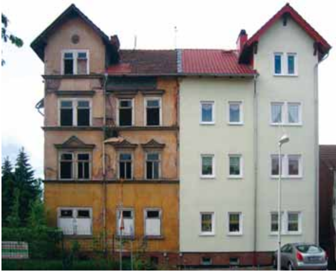
Abb. 1 Energetische Kaputtsanierung: Gründerzeitliches Doppelhaus in Eisenach. Die rechte Hälfte verlor mit der Verpackung jeden Charme, der linken erging es aber auch nicht besser: Sie wurde inzwischen abgerissen. Aufnahme 2007.
