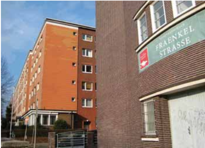
Abb. 4 Im Hintergrund Fassadenzerstörung mit Asbestplatten aus den 1960er Jahren. Im Vordergrund fachgerechte Fassadensanierung einer Schumacherschule aus den 1990er Jahren.
