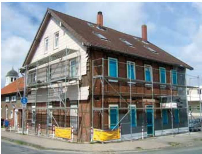
Abb. 2 Vom Regen in die Traufe: Fachwerkhäuser in Heisede. Kaum von Asbestplatten befreit, verschwindet das intakte Fachwerk unter Styroporblöcken. Aufnahme 2011.
