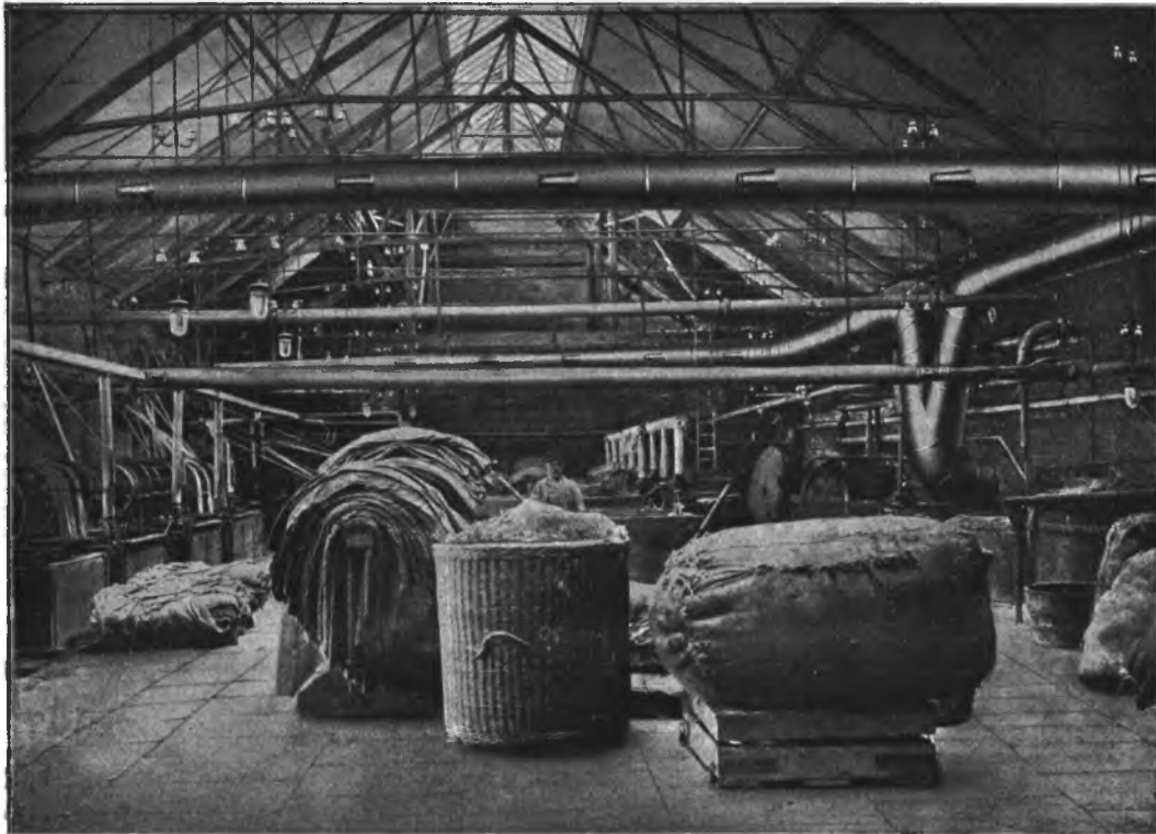
Fig. 30. Entnebelungsanlage einer Färberei, ausgeführt von der Firma Schilde.
