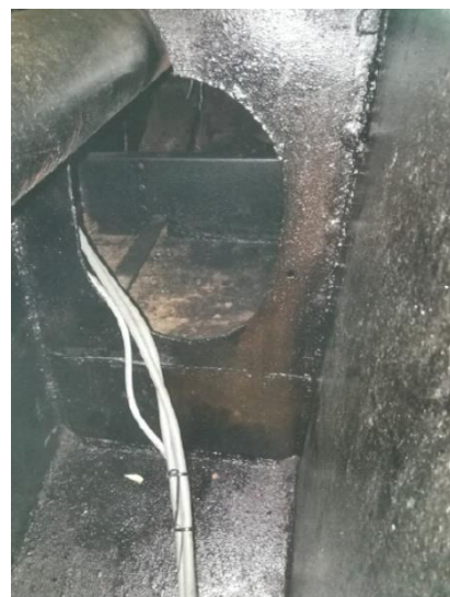
Kabel ohne Tragekonstruktion
