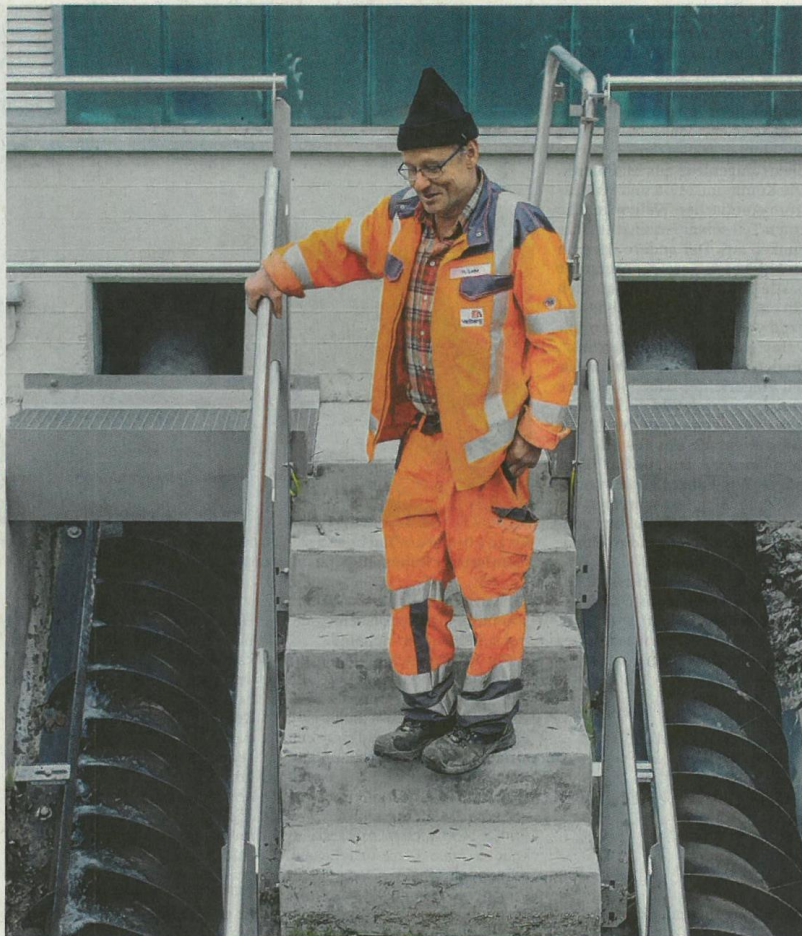
Klärwärter Helmut Lehr steht neben den beiden erneuerten Schnecken, die das Wasser aus dem Regenüberlaufbecken in das Kanalsystem und in die Kläranlage befördern. Foto: Sigrid Bauer
