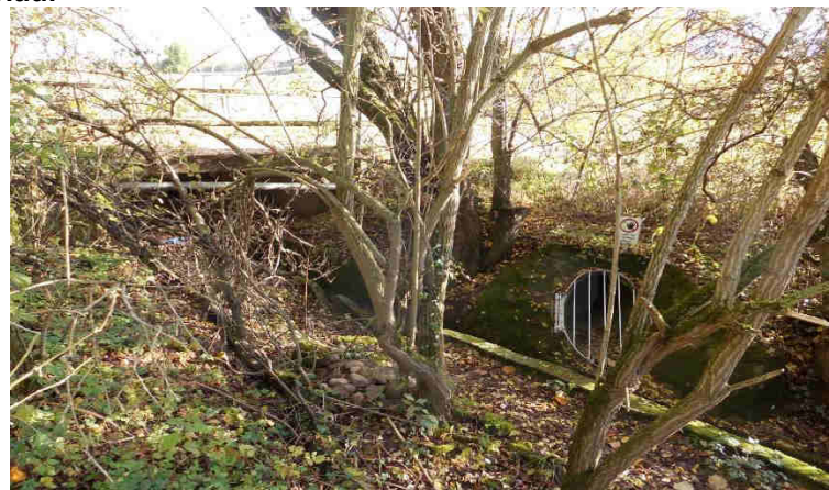
Abbildung 15: Auslauf Entlastungsleitung Regenüberlauf
