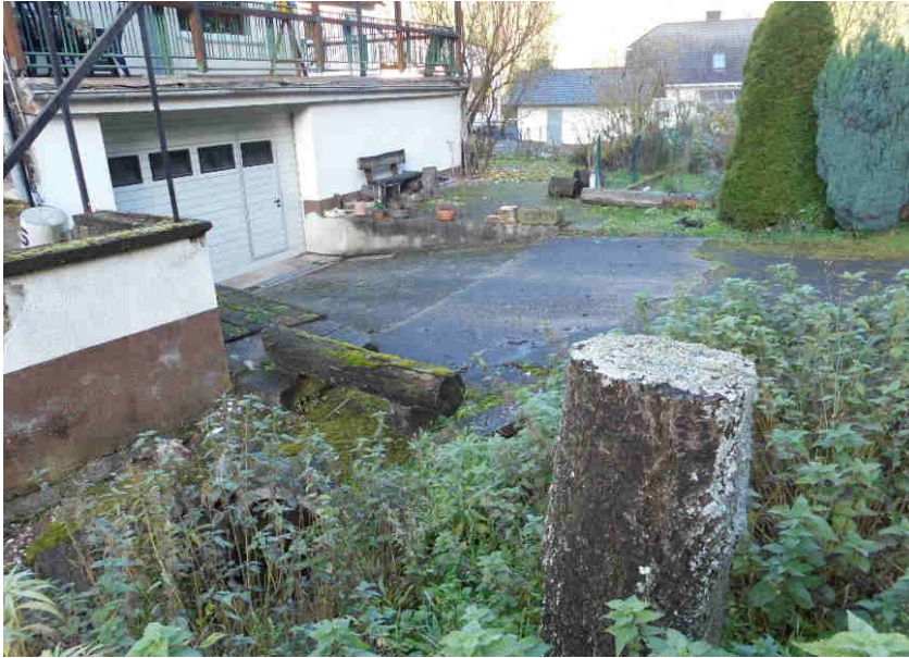
Abbildung 30: Durchlass DN 1000 (Gefährdeter Eingang)
