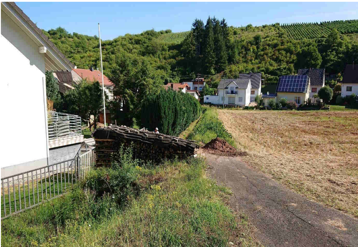
Abbildung 82: Weed Durchlass DN 600 - Gefährdung Gebäude 20a
