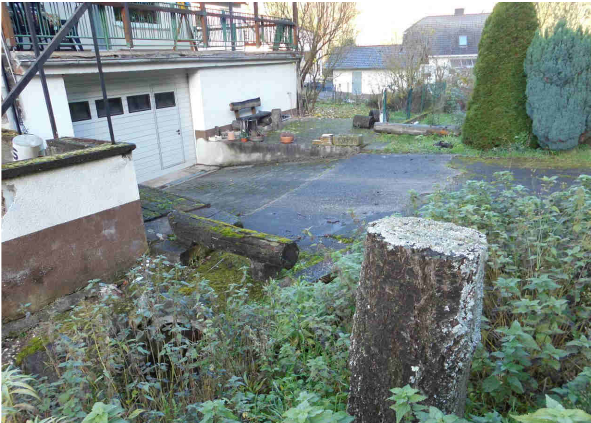
Abbildung 81: Weed Durchlass DN 1000 - Gefährdung Gebäude
