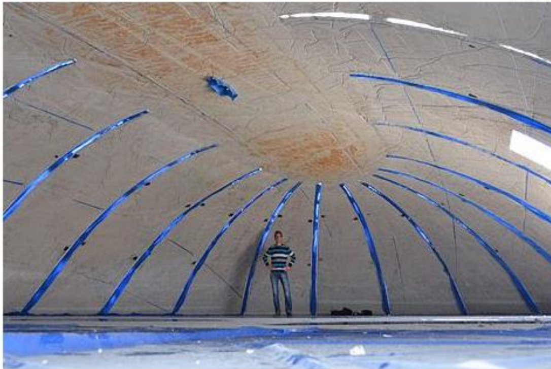
Nach dem Aufblasen sind nur noch die Reste der Luftkissen in den Fugen sichtbar
