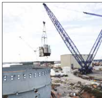
▼ Verankerungsspezialisten setzen das SyncHoist-System ein, um bei der Positionierung eines 1140 t schweren Moduls eines Kernkraftwerks jeden Hubpunkt separat oder zusammen synchronisiert präzise einzustellen und zu überwachen.
