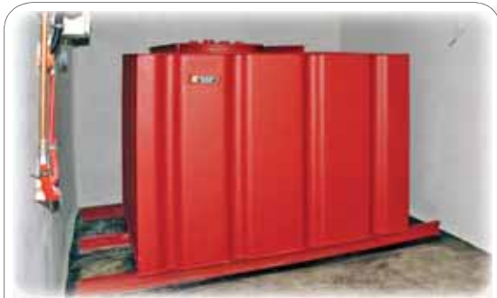
Neuer standortgefertigter Stahltank nach DIN 6625 (Außenansicht)
