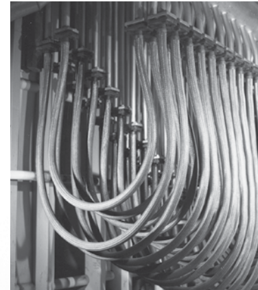
Bild 3.1.8 Metallschlauchleitungen in einer Etagenpresse
