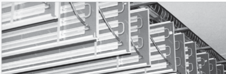
Bild 3.4.10 Geöffnete Kühldecke mit flexiblen Anschlussleitungen
