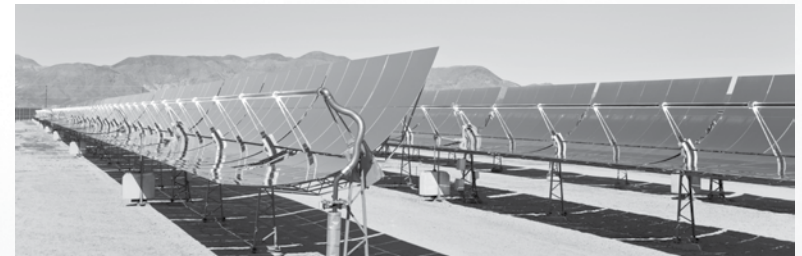
Bild 3.3.1 Solarfeld eines Parabolrinnenkraftwerks
