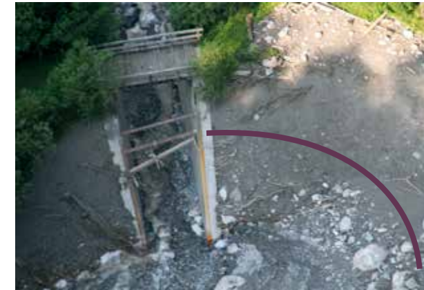
Abb. 2: Die ausgehobenen Balken der Geschieberückhaltesperre, der Murstoß kam von unten rechts, folgten der Dammböschung und schwappten auf die Beckenoberkante (lila Linie).
