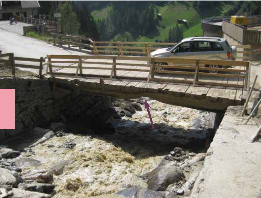
Abb. 11: Die Gemein- destraßenbrü- cke bei hm 4,5 wurde durch die Mure versetzt. Die Schäden am Tragwerk sind erkennbar (lila Pfeil).
