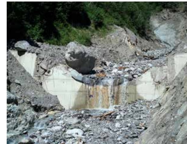
Abb. 3: Beschädigte Sperre der Staffelung oberhalb des Geschiebeauffangbeckens. Blockgröße ~12 m 3
