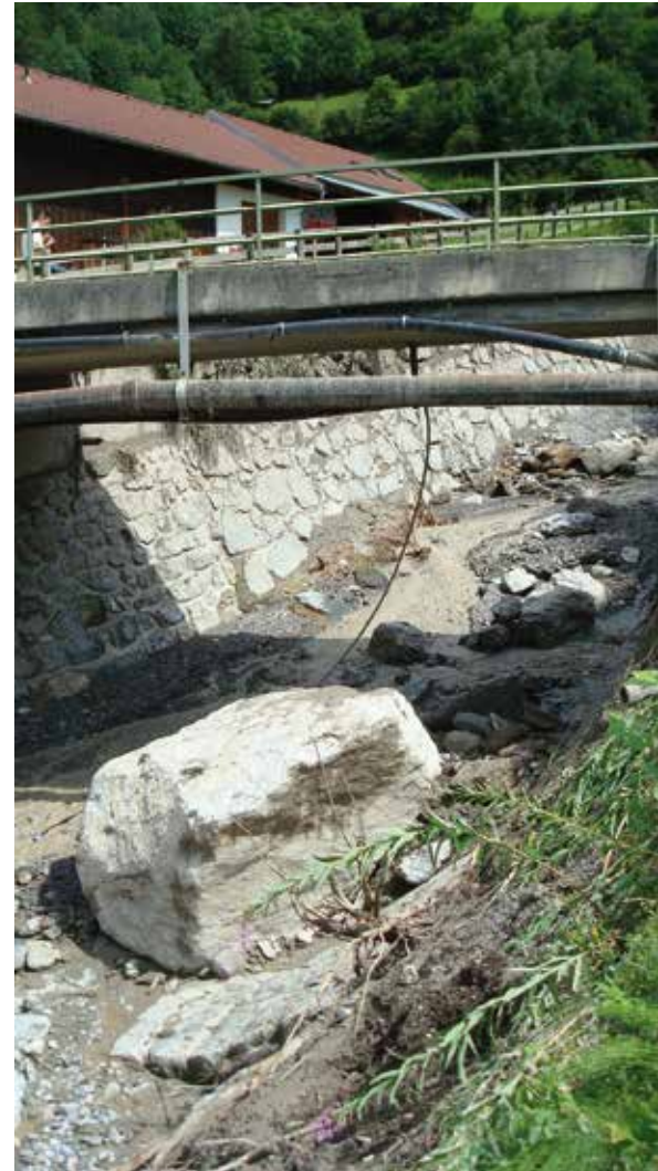
Abb. 1: Große Blöcke (~ 3 m 3 ) konnten die Geschieberückhaltesperre passieren und wurden im Siedlungsbereich abgelagert.
