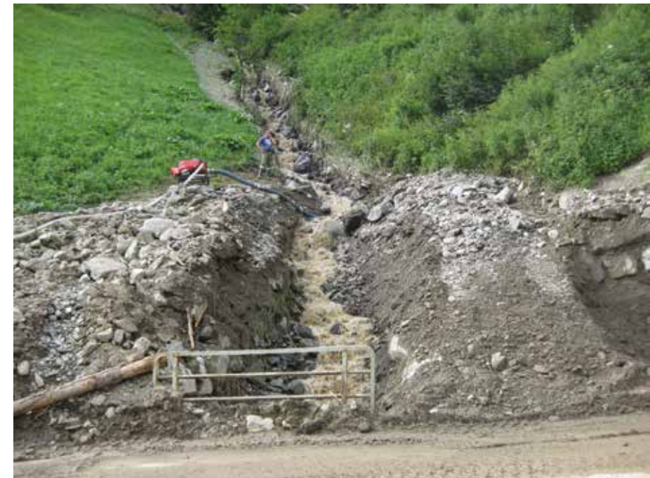
Abb. 17: Der Brückendurchlass bei hm 3,27 war zu klein; Verklausung und seitlicher Bachaustritt waren die Folge.
