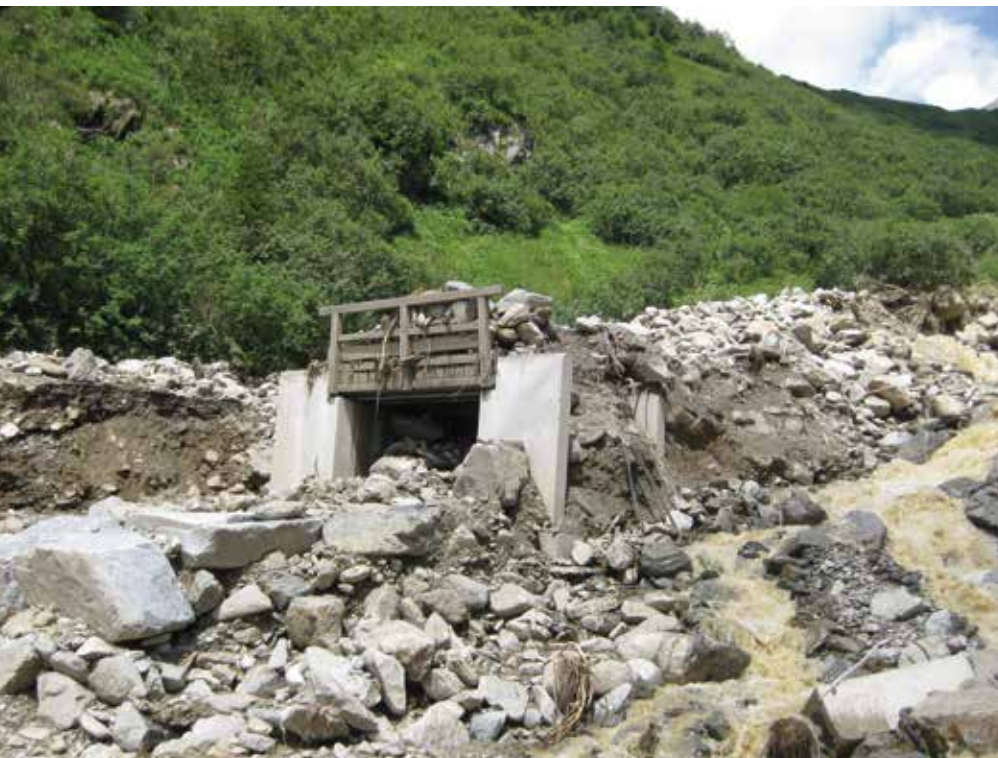
Abb. 12: Bereich der Grabenein- tiefung bei hm 13. Die Nachbö- schungen und Setzungser- scheinungen sind noch im Gange. Die ursprüng- liche Gerin- nesohle lässt sich aufgrund der Brücke erahnen.
