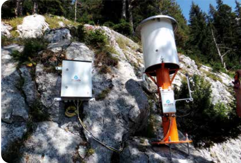
Abbildung 6: Totalstation (oben) und Solaranlage (unten) unterhalb der Pürger-Wand.
