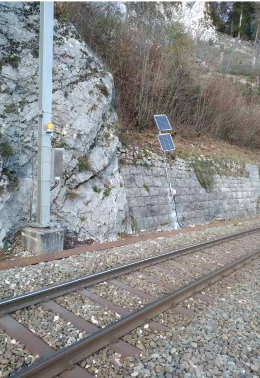
Abbildung 9: Warnlicht am Fahrleitungsmast montiert. Bei einem entsprechenden Ereignis wird der Lokführer gewarnt. Die Speisung erfolgt ab einer Solarstromversorgung mit Puffer-Batterie.
