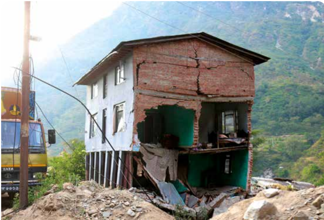
Abbildung 1: Vom Erdbeben zerstörtes Wohngebäude in der Nähe des Bhote Koshi Wasserkraftwerkes
