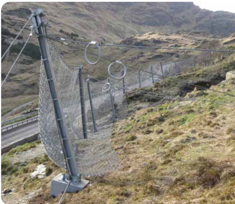
Abbildung 2: Installierte Barrieren in "Rest and Be Thankful"/ Schottland.
