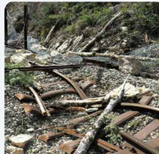
Abbildung 2: Steinschlag vom 15. März 2008, der die Bahntrasse der CJ über eine Länge von 140 m komplett zerstört hat (MFR Géologie-Géotechnique SA).
