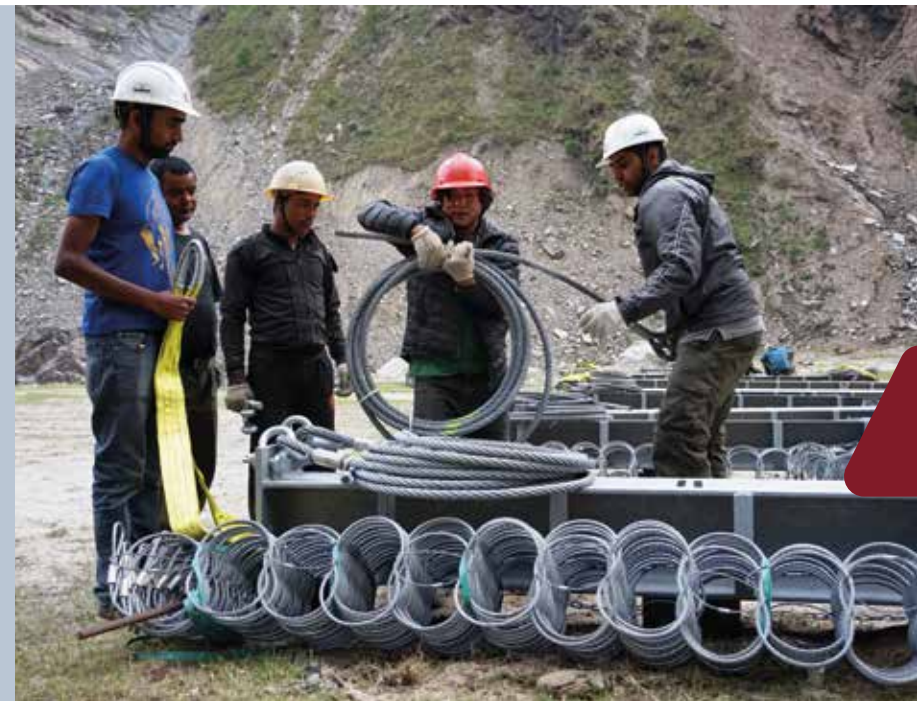
Abbildung 5: Vorbereitung der Stütze und der Omega-Netzpakete für die Helikoptermontage durch das Montageteam.
