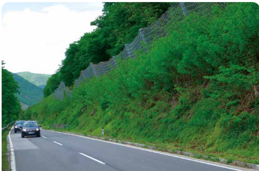
Abbildung 4: Steinschlagschutznetz Energieklasse 1.500 kJ an der Bundesstraße B33.
