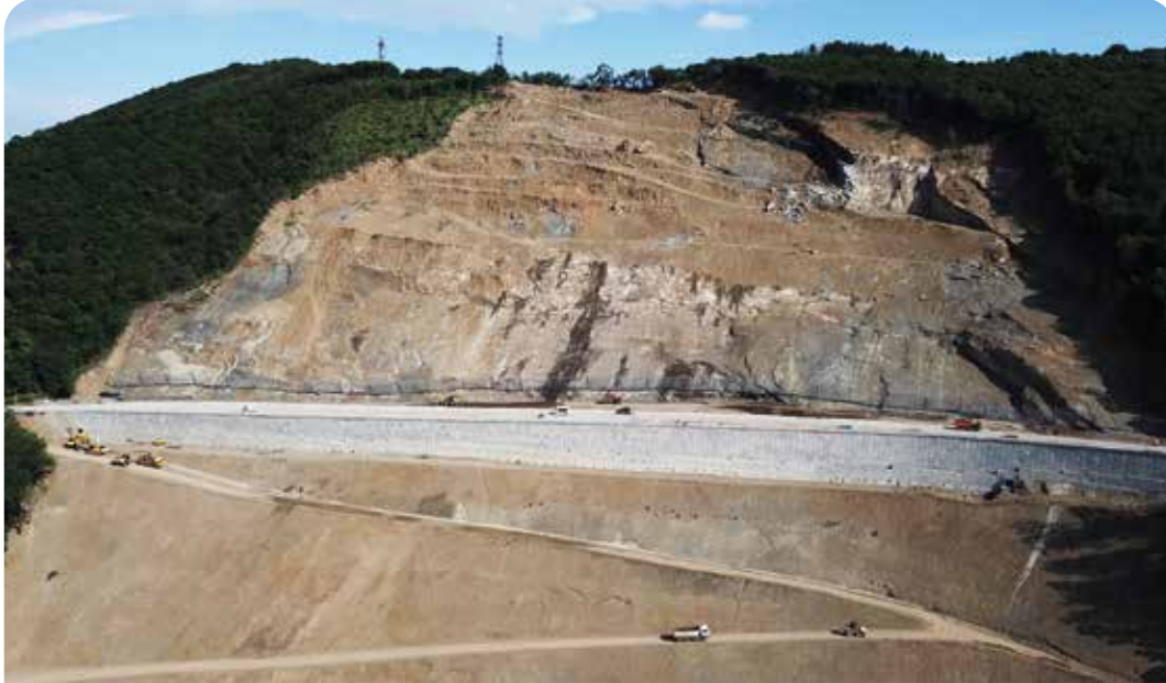
Abbildung 6: Ablösebereich der Felsgleitung mit neu errichteter Straße
