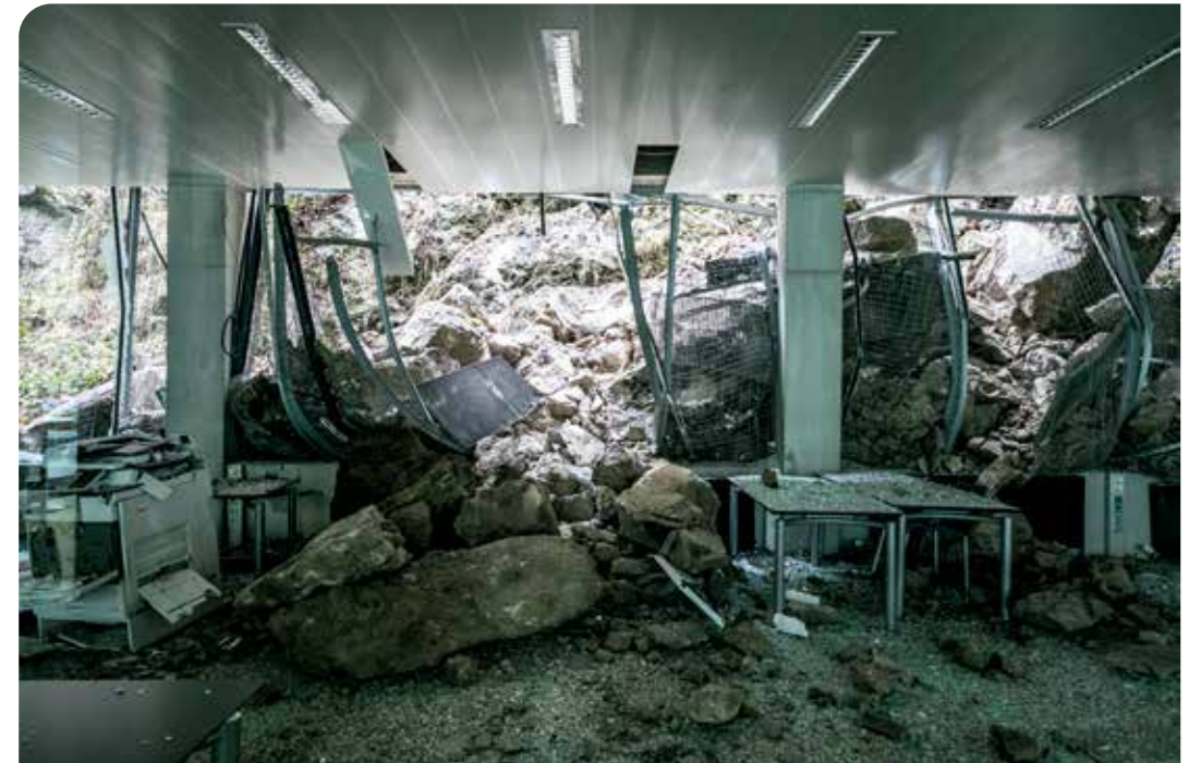
Abbildung 3: Felssturz aus rund 5 bis 10 m Höhe unmittelbar hinter dem Stadtarchiv beschädigt den Lesesaal schwer (Foto: Stadt Salzburg/ Wild + Team Fotoagentur GmbH)
