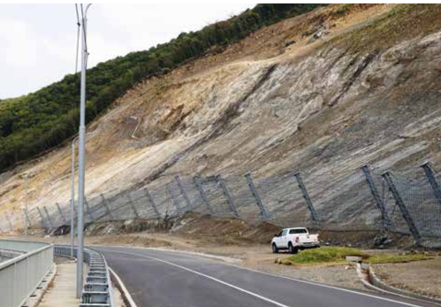
Abbildung 8: Steinschlagschutzsystem TSC-3000-ZD (3.000 kJ) entlang der neu errichteten Straße nach Tiflis
