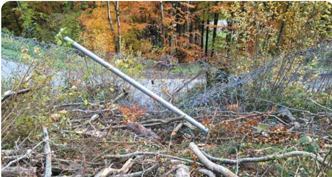
Abbildung 5: Am linken oberen Bildrand ist die durch Bohrungen geschwächte Bruchstelle des Stützenkopfes zu sehen
