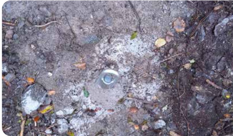
Abbildung 3: Schäden und Mängel aus der Herstellung von Mikropfählen; Unzureichende Beweglichkeit des Anschlusspunktes (oben); Herstellungsmangel des Verpresskörpers im Kopfbereich (unten)
