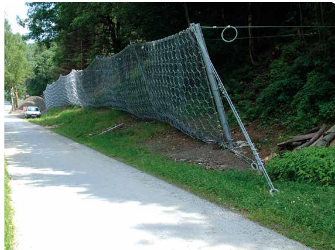
Abbildung 7: Bautype der Steinschlagschutznetze mit bergseitig abgespannten Pendelstützen (Foto: WLV)
