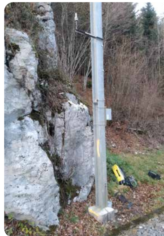
Abbildung 5: Alarmunit light montiert an einem Fahrleitungsmast. Sie empfängt Funksignale vom Gateway und löst die Warnsignale (Drehlichter) aus. Dieser Anlageteil wird ebenfalls durch Photovoltaik gespeist.
