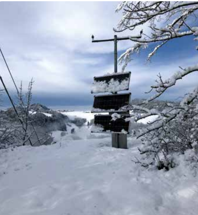
Abbildung 3: AarteLink Gateway Standort 1 im Südosten der Tabeillon-Schlucht auf 890 m.ü.M. Das Kommunikationskabel am linken Bildrand gehört nicht zur Anlage. Es überspannt auf einer Länge von 550 m die 200 m Tiefe Schlucht, an deren Nordrand die Steinschlagschutznetze liegen. Der Standort bedient 2 Bereiche à 39 und 37 Geosensoren mit je einem AarteLink-Gateway und je einem Transceiver. Die Insel-Stromversorgung erfolgt über Photovoltaik und Akkumulatoren. Der Fernzugriff des Monitors erfolgt über GSM/4G Gateways mit redundanter Netzanbindung über zwei verschiedene Telecom Carrier.
