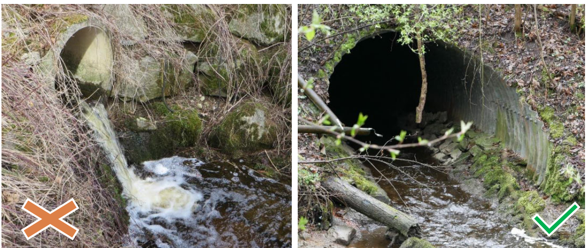
Abbildung 7-2: Negativbeispiel für einen zu gering dimensionierten Durchlass mit Absturz unter einem Wirtschaftsweg (links). Positivbeispiel für einen durchwanderbaren Durchlass unter einem Fahrweg mit durchgehender Gewässersohle und einem Uferstreifen (rechts)
