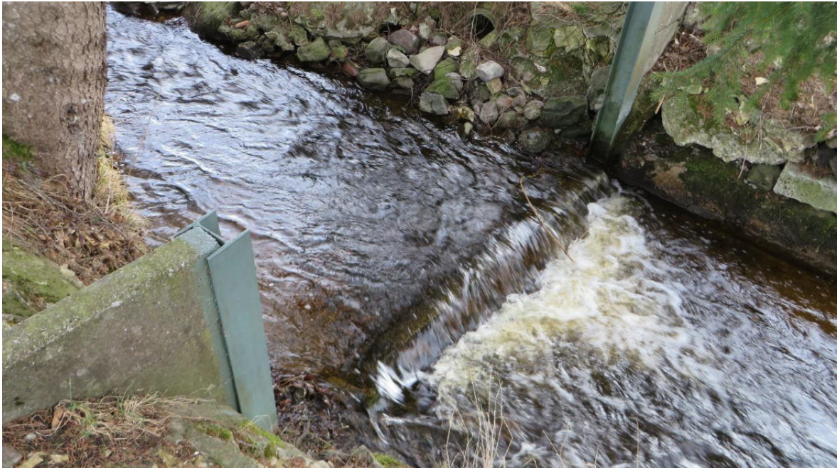
Abbildung 7-1: Beginnende Tiefenerosion unterhalb einer mobilen Stauwand zur Löschwasserentnahme. Solchen Erosionserscheinungen und sich einstellenden Wanderungshindernissen für bodenorientierte Fischarten kann durch Vorlage einer rauen Steinrampe vorgebeugt werden.
