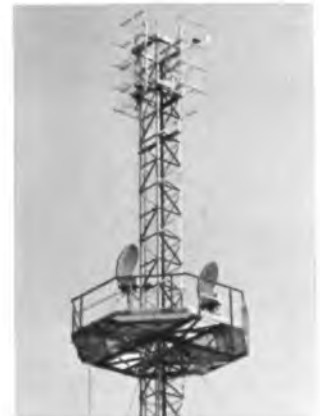
Bild 3. Antennenmast mit vier Achterfeldern und den Endstellen der Richtfunkstrecken
