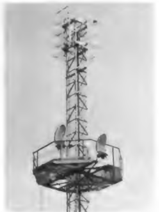
Bild 3. Antennenmast mit vier Achterfeldern und den Endstellen der Richtfunkstrecken
