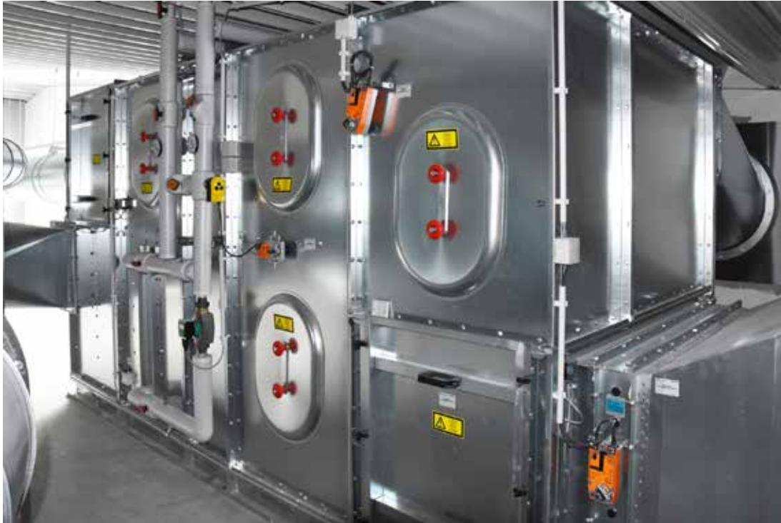
Die Lüftung kann zwischen Umluft und Abluft in Kombination mit einer Wärmerückgewinnung umgeschaltet werden.
