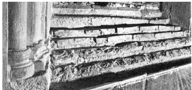
Zürich. Grossmünster. Hinterer Chor. Fensterbank des mittleren Ostfensters vor neuer Übermörtelung.
