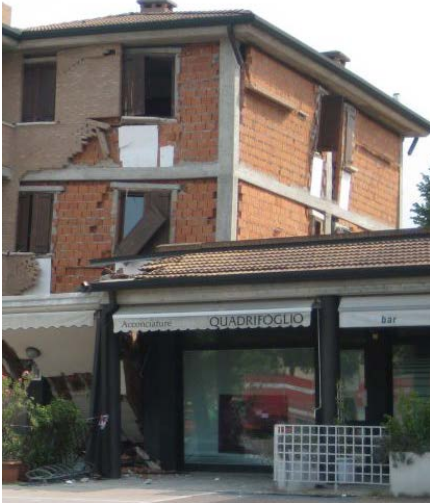
Abbildung: 1: Schädigung von Ausfachungswänden in und senkrecht zur Ebene
