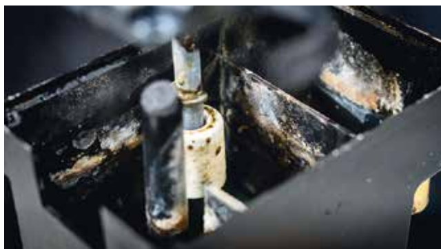
Bilder wie diese aus der Freien Fallstrecke einer Dentaleinheit überzeugten Janßen, sich für SAFEWATER zu entscheiden.
