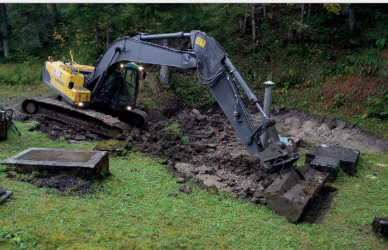
Abb. 11: Beginn der Renaturierungsarbeiten am 4.10.2016. Freilegung der Stahlbetondecke. Foto: Robert Seebacher Fig. 11: The beginning of the renaturation on October 4, 2016 and exposure of the concrete ceiling.
