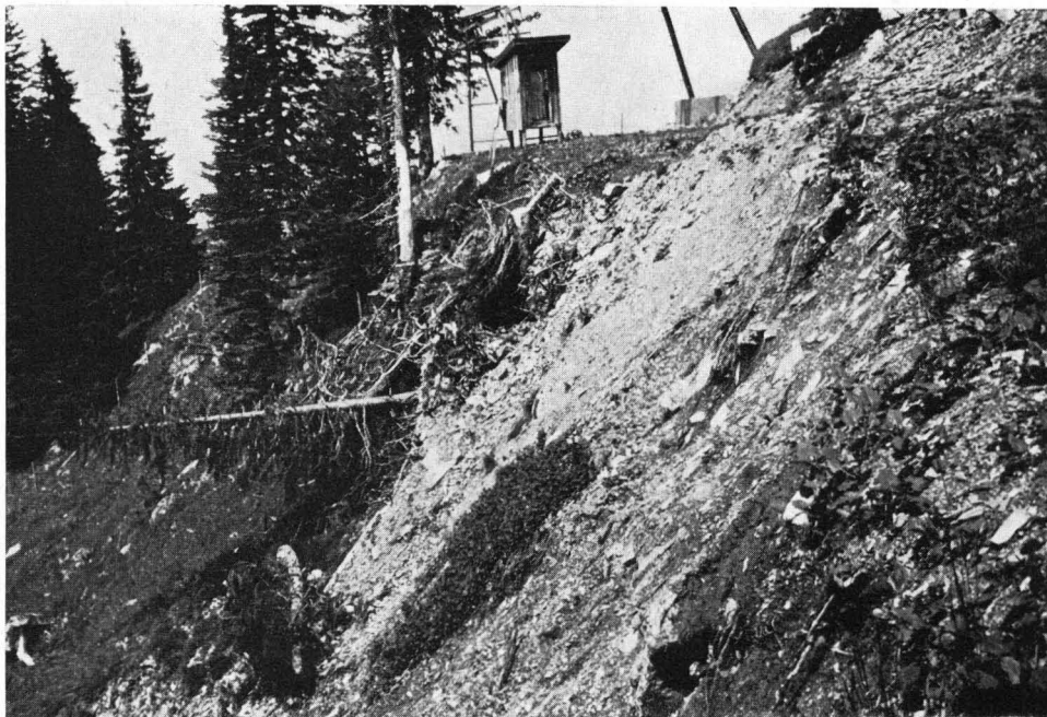
Abb. 13 Rutschungen beim Grasgehren-Lift
