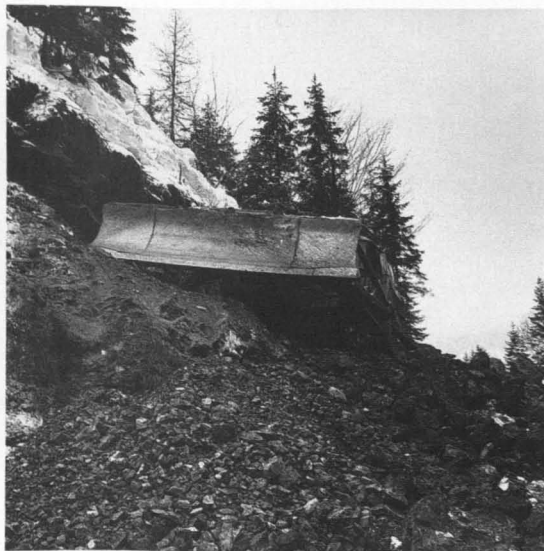
Abb. 8: Forstwegbau nach waldschädigenden Nutzungen. Je mehr Wälder nach waldschädigenden Nutzungen (naturferne Jagd, Waldweide, Forstwirtschaft) zu sanieren sind, desto mehr Forstwege müssen noch gebaut werden.
