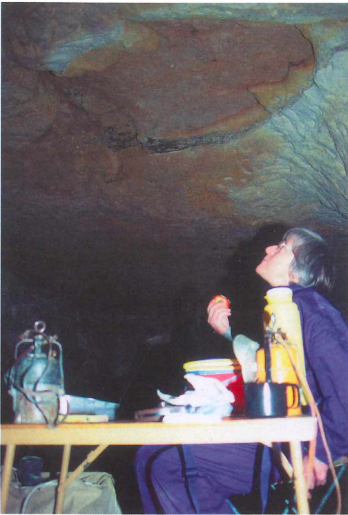
Abb. 41: Schaliger Verbrauch an einer Kellerdecke. Foto: Erich Wunderlich
