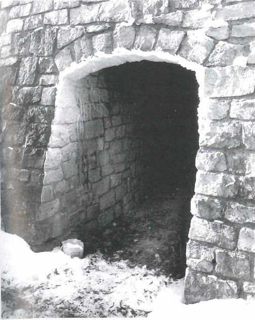
Abb. 43: Rauhreifbildung am nördlichen Kellereingang, verursacht durch die infolge statischer Bewetterung austretende warme, feuchte Luft
