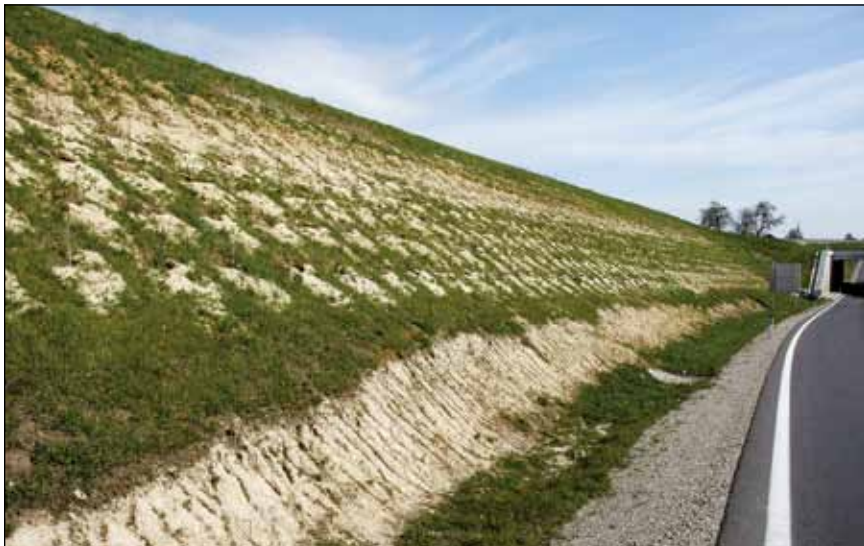
Abb. 27: Die mächtige Böschung an der Bundesstraße 148 nahe Altheim. Mit einem speziellen Bohrer wurden die Löcher für die Sträucher ausgehoben. Gepflanzt wurde leider wieder ein buntes Gemisch gebietsfremder Arten.
