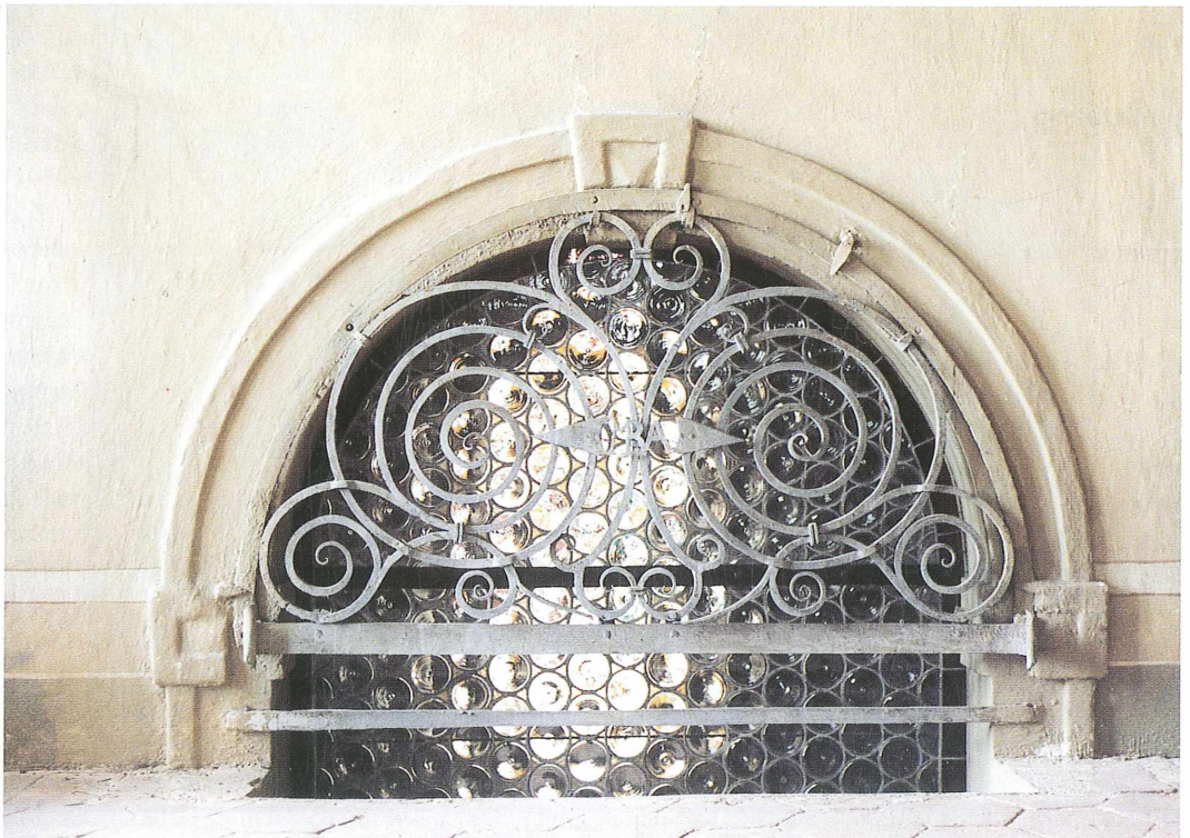
Abb. 3: Durch bauliche Erweiterung 1643 verstelltes Ostfenster der Kapelle
